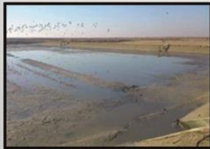
تصویر ۲: تشکیل رسوبات در کف استخر ناشی از شیب بندی نامناسب کف استخر
